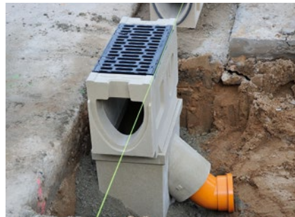
Der Einlaufkasten ist so konzipiert, dass auch große Wassermengen aufgenommen und abgeleitet werden können.
