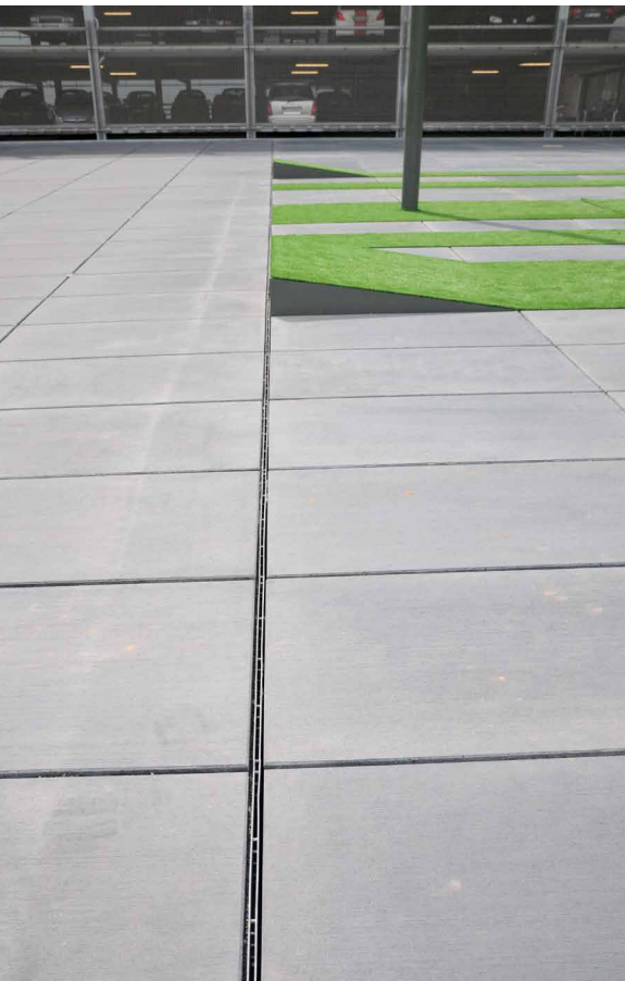
In den Fugen der großformatigen Betonpflasterplatten ist lediglich der Schlitz der ACO DRAIN® Multiline V 150 S Entwässerungsrinne zu sehen
