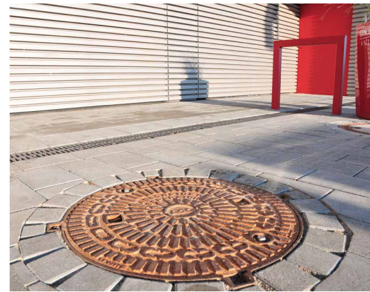
Schachtabdeckung der Fettscheideranlage Lipumax NS 7. Die Anlage trennt die Fette und Öle aus dem Abwasser des Restaurants, bevor es in die öffentliche Kanalisation eingeleitet wird.
